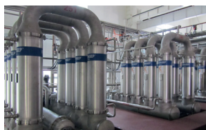
Kerasep filtration unit
