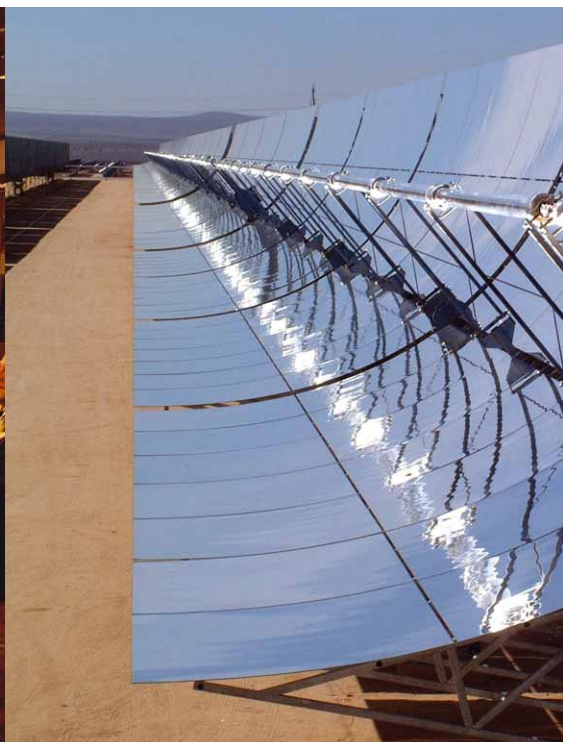
Solarthermisches Großkraftwerk mit Parabolrinnen-Technologie. Bild: BSW-Solar/Solar Millennium
