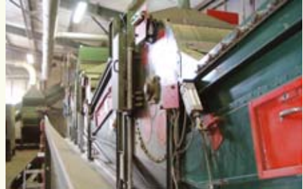
Abb. 14: Faseraufschlussanlage (Quelle: BaFa GmbH)
