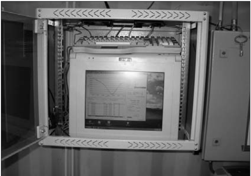
Abb. 21: Installation des Industrie-PCs mit implementiertem PLSR-Kalibrationsmodell zum Inline-Prozessmonitoring des oTS-Gehaltes mit der MWTS PP guard Sonde am Mannloch der Biogasanlage Breitenworbis
