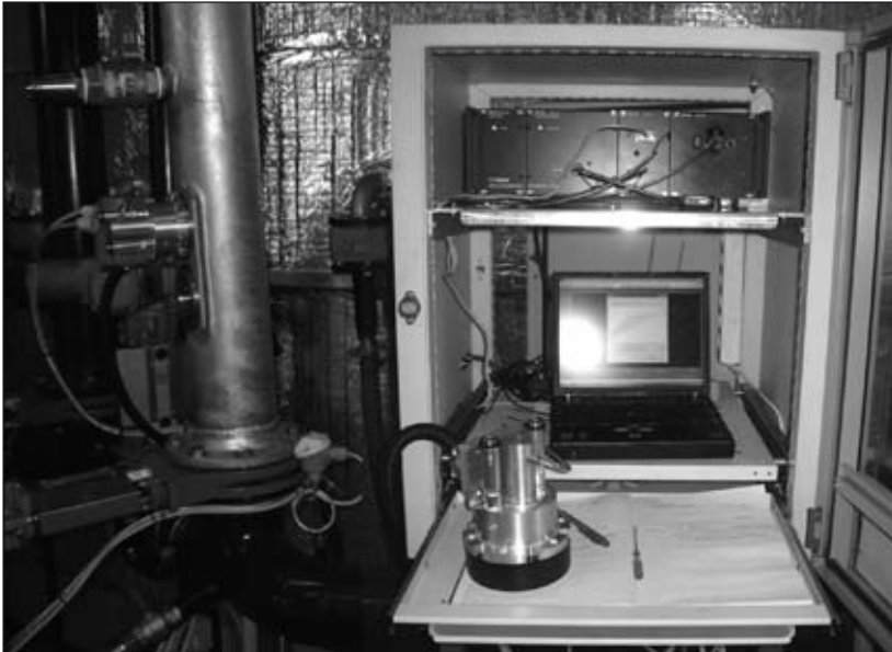
Abb. 4: NIRS-Messstelle (links) und Spektrometer (rechts) im Pumpenhaus der Biogasanlage in Linnau
