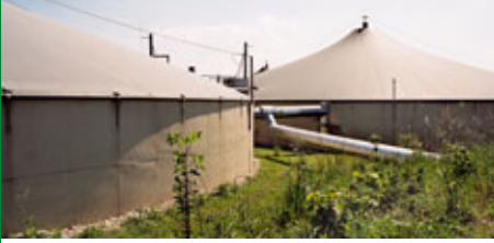
Durchflussbiogasanlage mit Folienhaube als integrierter Gasspeicher
