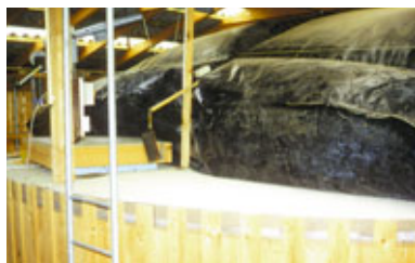
Biogasfolienspeicher im belüfteten Dachraum über dem Faulbehälter
