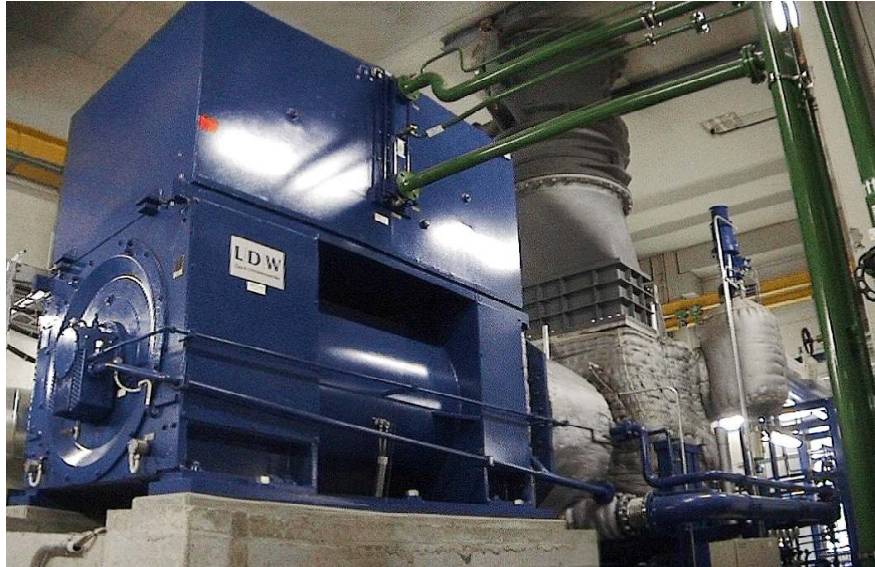
Abbildung 2: Turbine mit Generator 6 MW el
