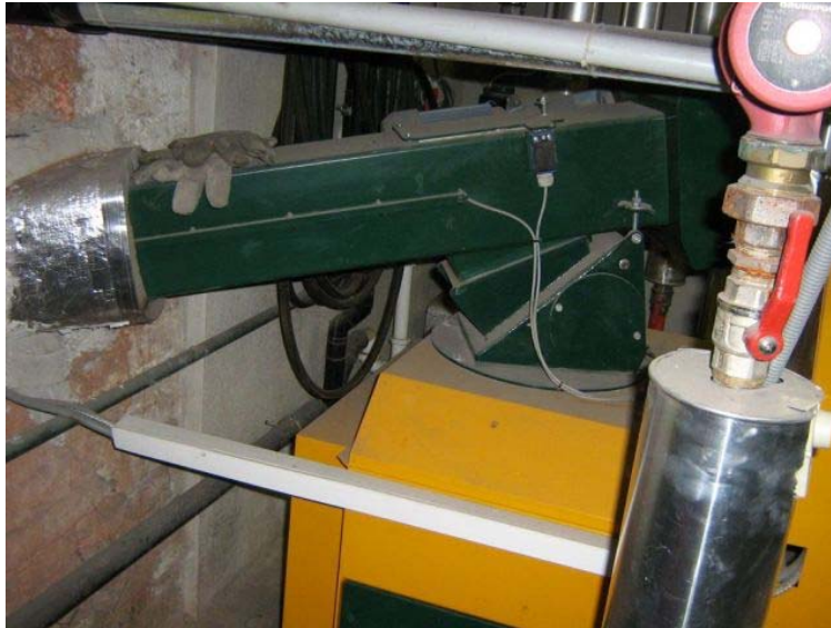
Abbildung 34 Zuführung der HHS über Förderschnecke aus Lagerraum in Kessel ummantelter, ca. 15 X 15 cm Kanal, in dem eine Schnecke verläuft)
