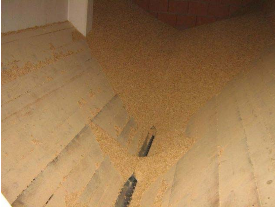
Abbildung 37 Schrägboden-Pelletspeicher mit Förderschnecken-Kanal
