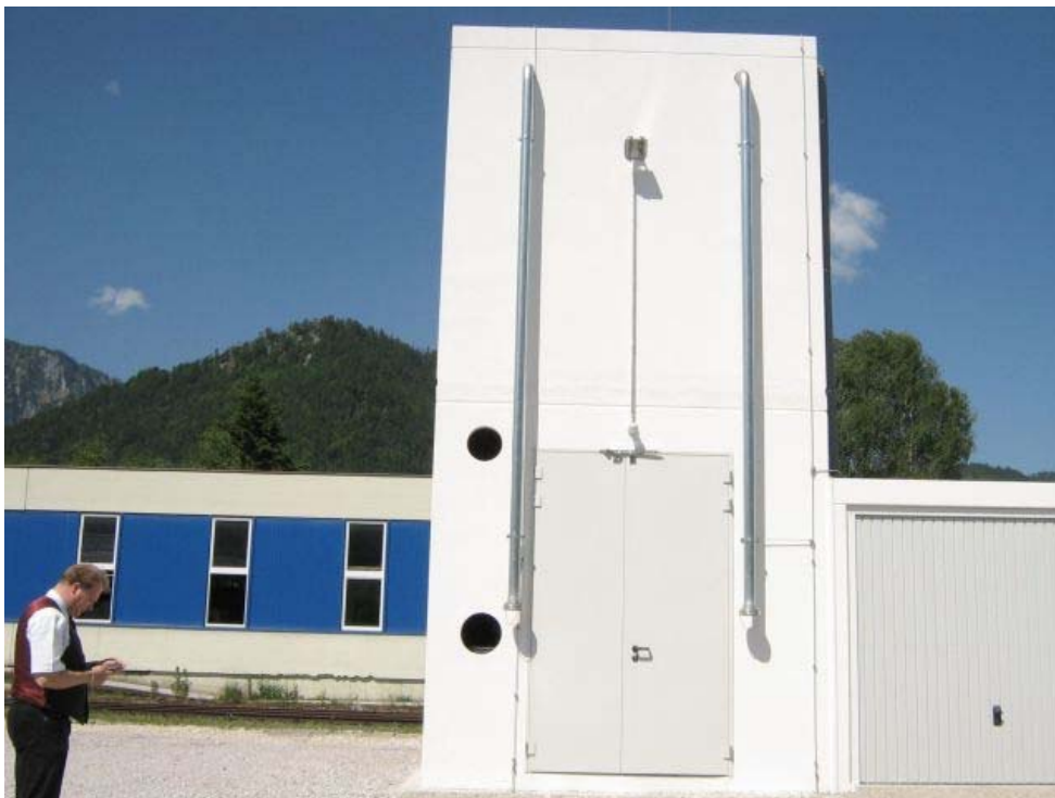
Abbildung 40 Heizhaus/Brennstofflager in aufeinander gestellten Fertiggaragen. 450 kW; Scharnstein (Österreich)
