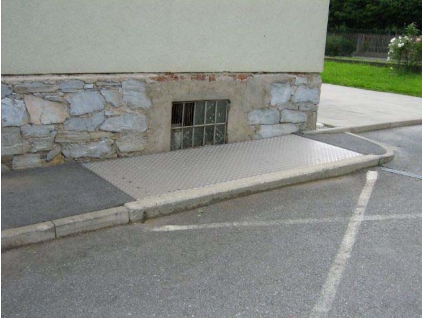
Abbildung 32 HHS-Brennstofflager-Abdeckung. MFH, 140-kW. St. Margarethen, Steiermark.
