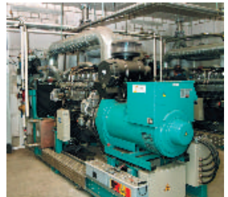
Ein Block geht täglich kurzzeitig vom Netz und fängt den Spitzenbedarfstrom ab (Foto: Eggersmann)
