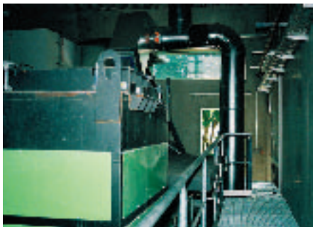
Blick in das neue Heizkraftwerk: 21 Land- und Forstwirte haben sich auf Initiative des Maschinenrings Neuburg-Schrobenhausen und der örtlichen Waldbesitzervereinigung zusammengetan und gemeinsam ein Hackschnitzelheizwerk finanziert
