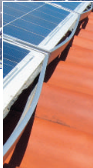
Durch mangelhafte Modulstatik haben sich die unteren Rahmenprofile verformt (Quelle: www.solar-sachverständiger.de )
