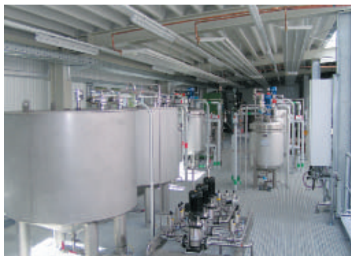
Abbildung 3: Teilansicht (Hydrolyse, Sterilisation) der Pilotanlage
