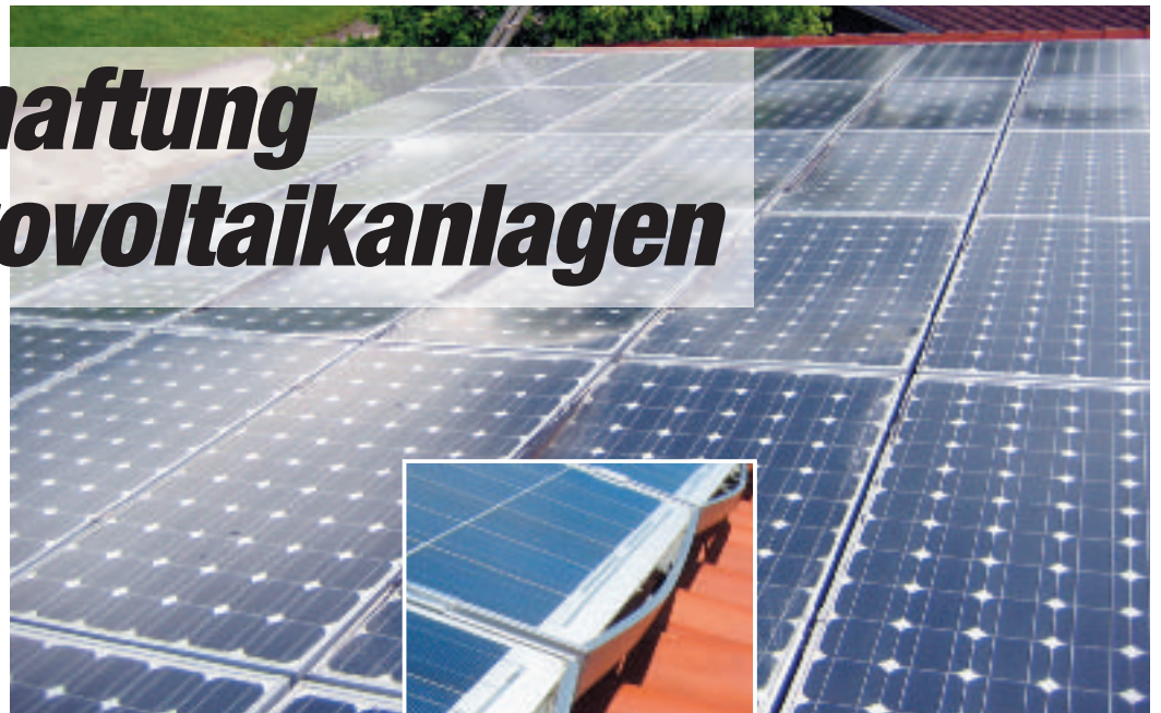
Instabile Solarmodule mit „Durchhänger“ (Quelle: www.solar-sachverständiger.de )
