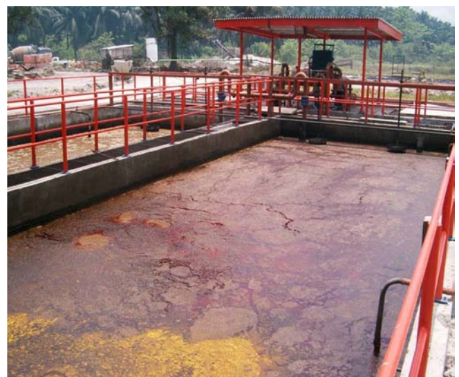
Zwischenlagerung des bei der Palmölgewinnung anfallenden Abwassers in einem Abkühlbecken. © IFEU
