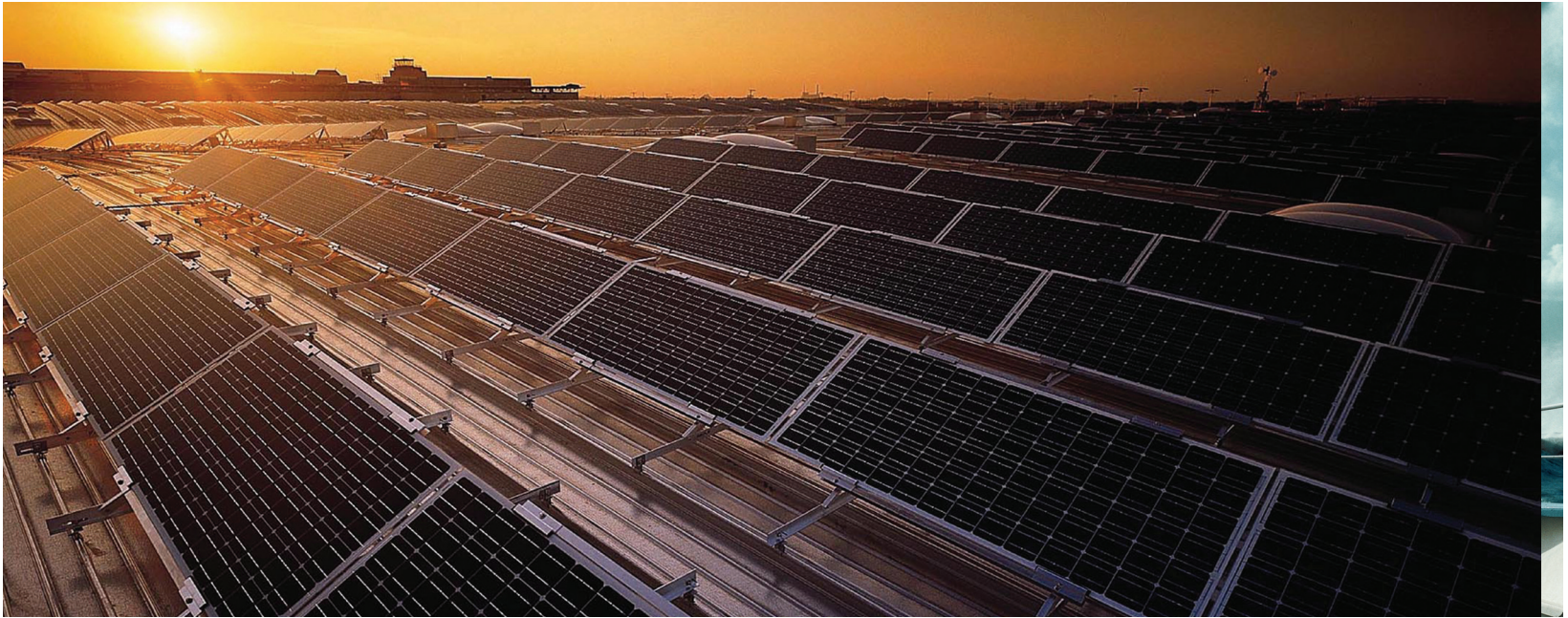
Die weltweit größte Photovoltaik-Dachanlage auf der Münchner Messe hat eine Nennleistung von rund 1 MW el . Sie speiste 2004 rund 1000 MWh elektrischer Energie ins Netz (Foto: Shell Solar).
