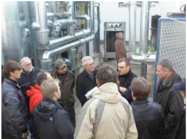
Besichtigung in Pliening bei München: die erste Anlage in Deutschland, die veredelt Biogas als Ergänzungsgas in das Erdgasnetz einspeist (Foto: Dieter Schaarschmidt)
