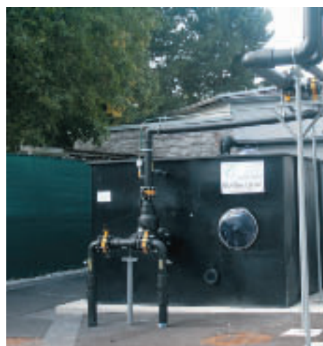
Ein Biofilter sichert eine geruchsfreie Emmission (Foto: fnp)
