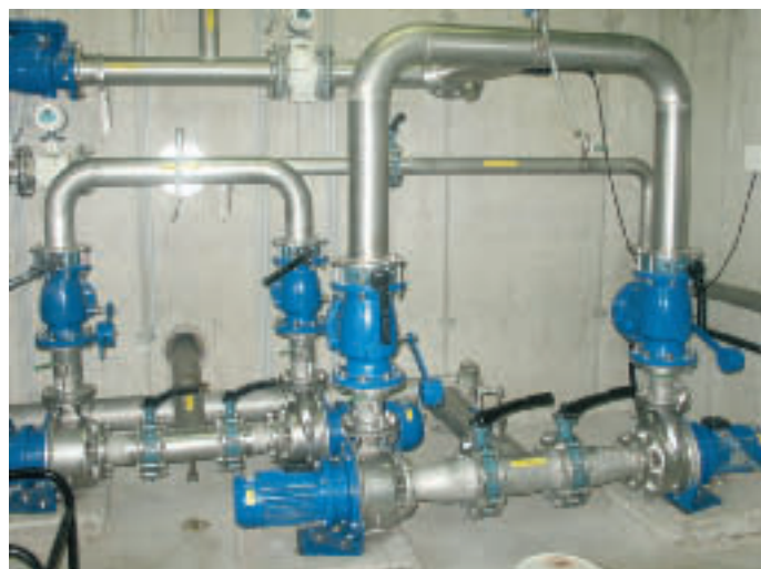
Die klar gegliederten Fließwege sind mit automatischen Ventilen versehen (Foto: fnp)
