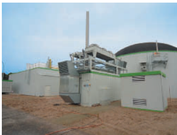
Die Anlage in Garlipp ist nun in Betrieb (Foto: Dalkia)
