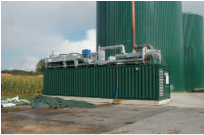
Ein BHKW mit 347 kW el und 390 kW th ist direkt am Standort der Biogasanlage installiert (Foto: fnp)
