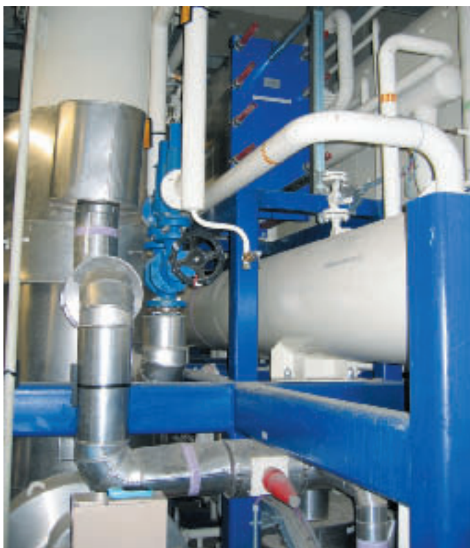
Die mit Bioenergie betriebene Absorptionskälteanlage der Brauerei Müller in Pfaffenhofen versorgt nicht nur das Kühlager, sondern auch Anlieger mit Kälte (Foto: eta Energieberatung)
