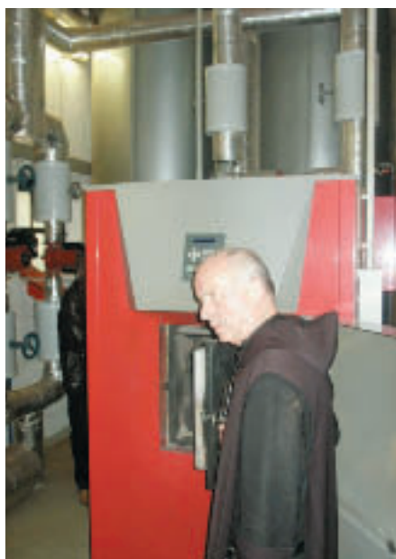
Die Benediktinerabtei Kornelimünster hat auf Holzhackschnitzelheizung umgestellt, Jahresverbrauch: 800 m 3 . Im Bild: Abt Albert Altenär vor dem vollautomatisch betriebenen Brenner (Foto: fnp)
