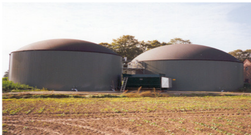
Abb. 5: Fermenter und Lagerbehälter
