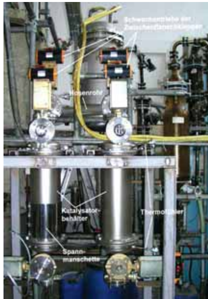
Anlage zum katalytischen Hydrocracken von Teer am Gegenstromvergaser.
